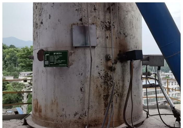
易操作监测平台
