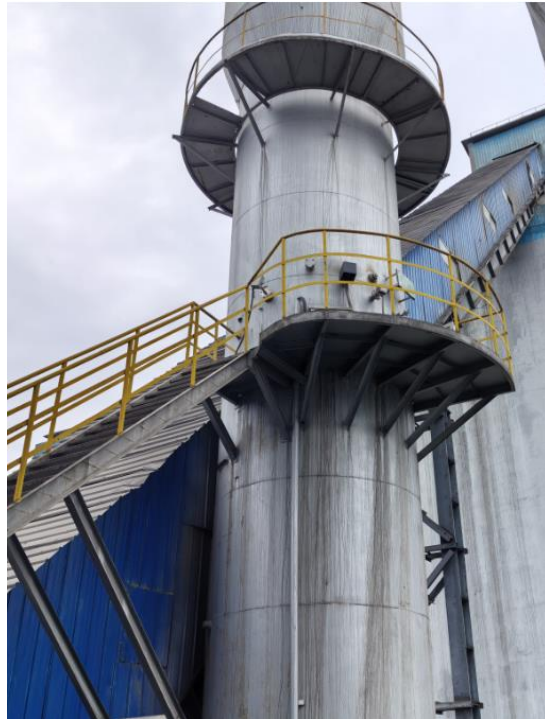
易操作监测平台
